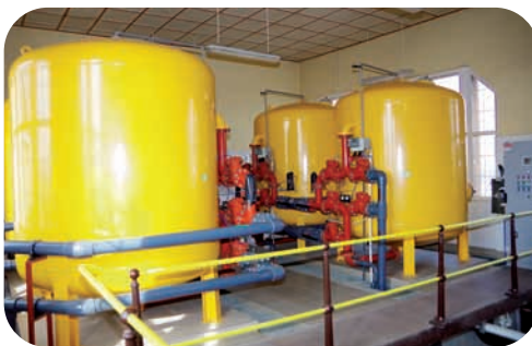
Potężne filtry Stacji Uzdatniania Wody w Środzie uzdatniają ok. 2 mln m 3 wody rocznie
