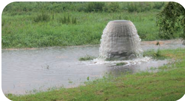
Przeciążenie hydrauliczne kanalizacji w wyniku ulewy
