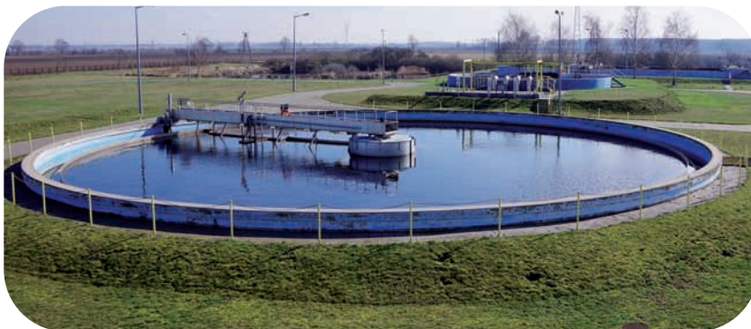
Zmodernizowana w 2002 roku gminna oczyszczalnia ścieków w Chwałkowie - osadnik wtórny
